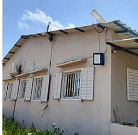
Photo : Lampes solaires au dispensaire de Kounkané (Sénégal).
